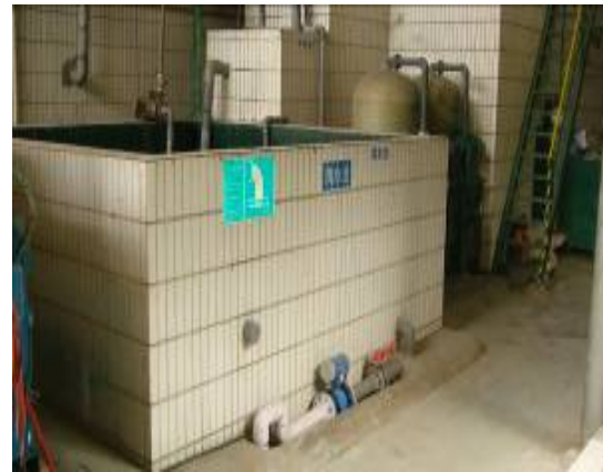
图四：污水排放池
