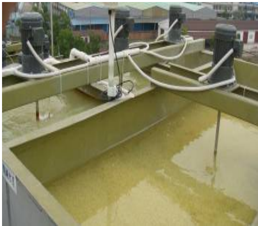
图六：储水调整池
